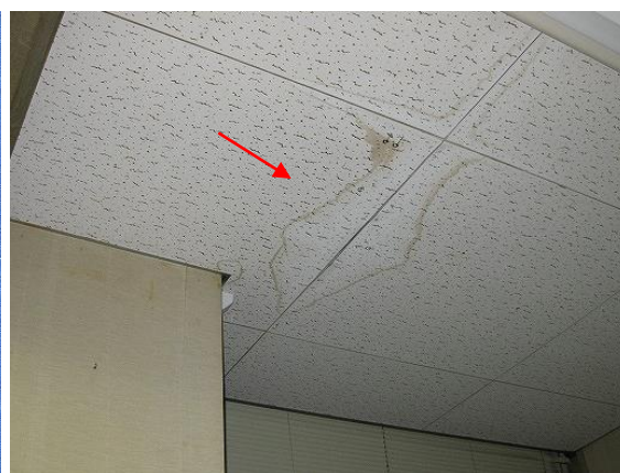
天井の雨漏りの跡
