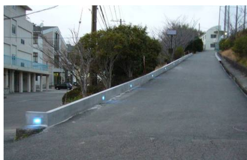
■震度5強以上の地震で点灯する避難誘導灯
