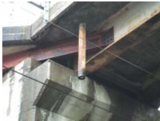
排水管：健全度1.0
