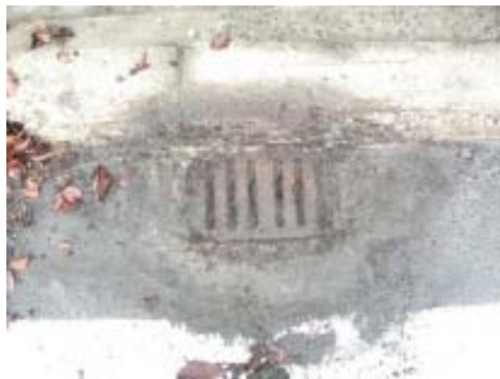
排水柵：健全度4.0
