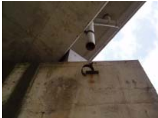
排水管：健全度3.0
