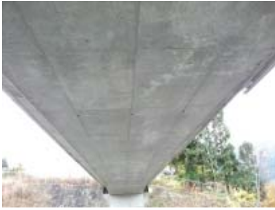
主桁：潜伏進展期(健全度4.0)
