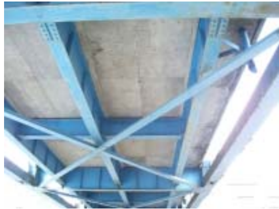
床版：潜伏・進展期(健全度4.0)
