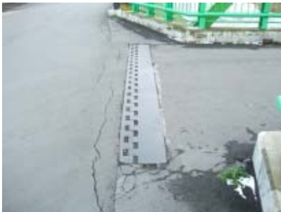
伸縮装置：健全度4.0
