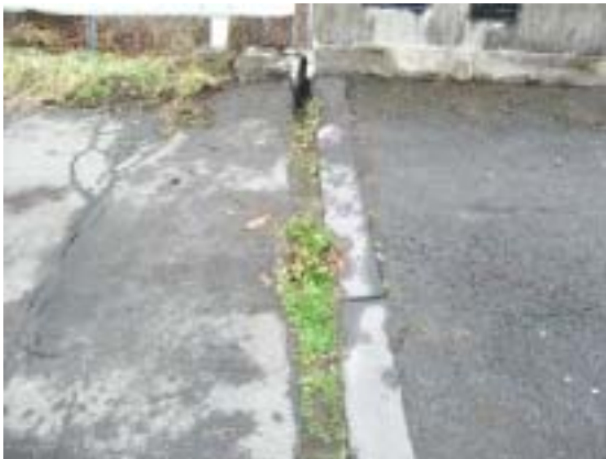
伸縮装置：健全度2.0
