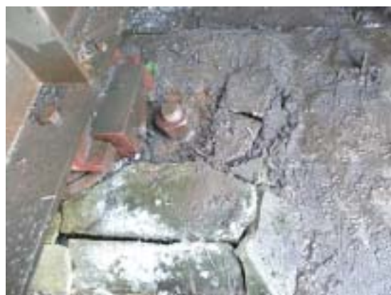
沓座モルタル：健全度2.0
