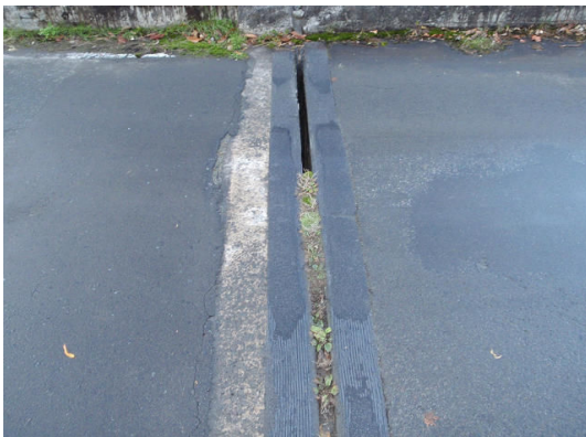
伸縮装置：健全度2.0
