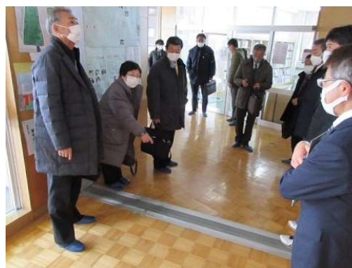
校舎内廊下の劣化箇所を調査
