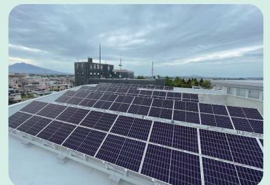
屋上太陽光発電パネル（25KW）
