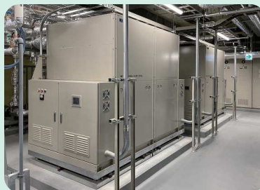
地下水を使用した水冷チャラー
