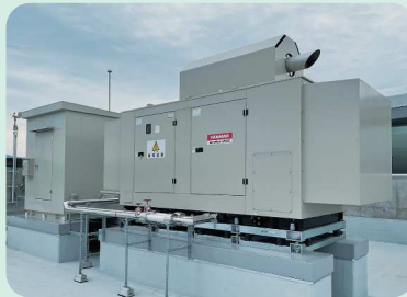
屋上非常用発電機（最大315KVA）
