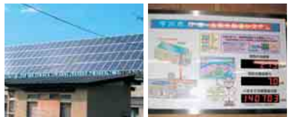
太陽光発電システム
