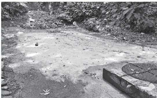
大木平第2水源の取水施設
