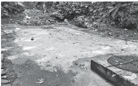
大木平第2水源の取水施設
