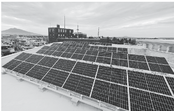
庁舎屋上の太陽光発電パネル
