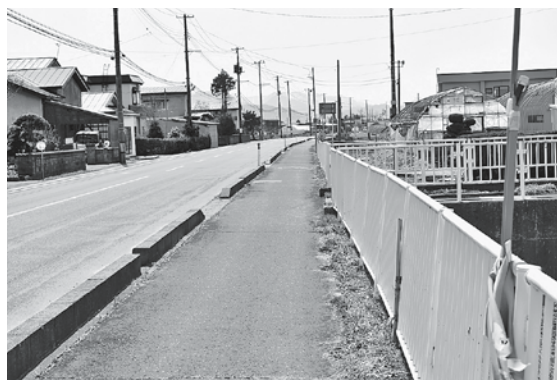
市道尾上小和森線には防雪柵が設置されていません。
