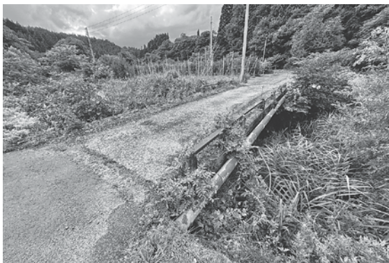
不動川を横断する橋は老朽化が激しい状態です。
