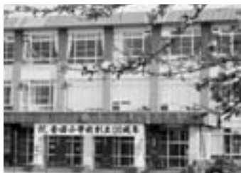
修繕前の校舎
