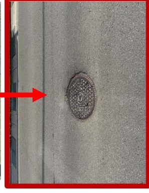
マンホール周辺にくぼみあり
