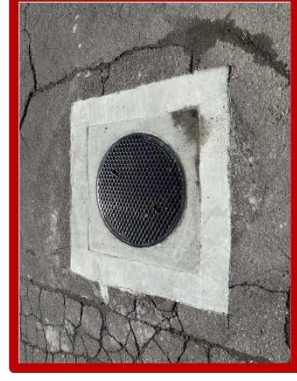
マンホール②(修理済)
